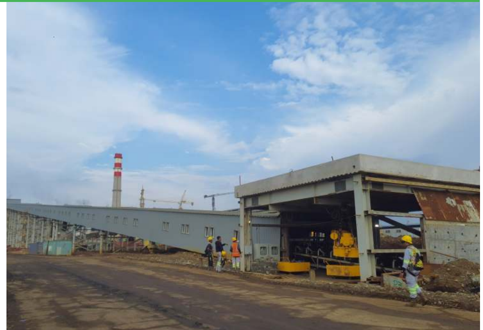
Sistem Ban Berjalan di HJF untuk menggantikan penggunaan kendaraan berat
